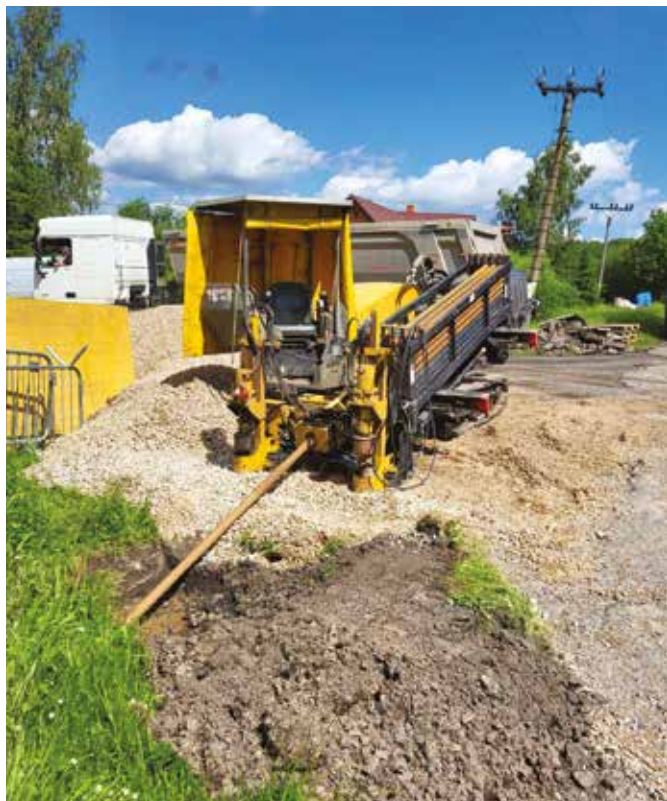
Podvrt pod silnici u bytovek pro vodovodní přívadeč od Záruby do Kozojed
